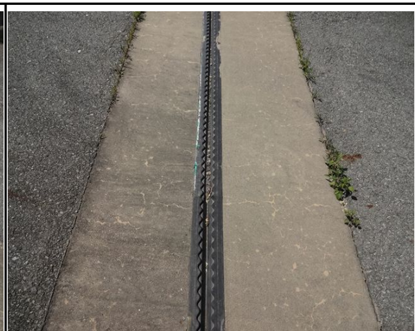
A2 후타재 균열
