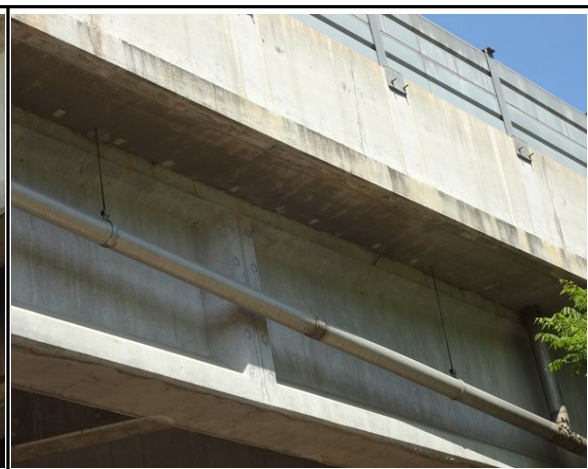
하행선 S1 지지대 탈락
