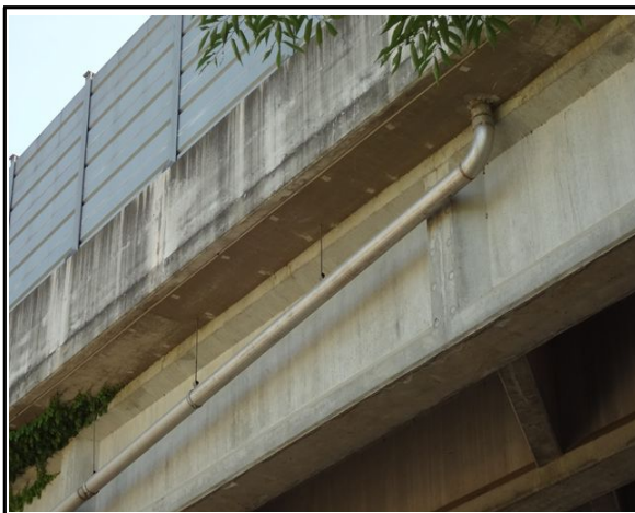
상행선 S1 연결고리 탈락
